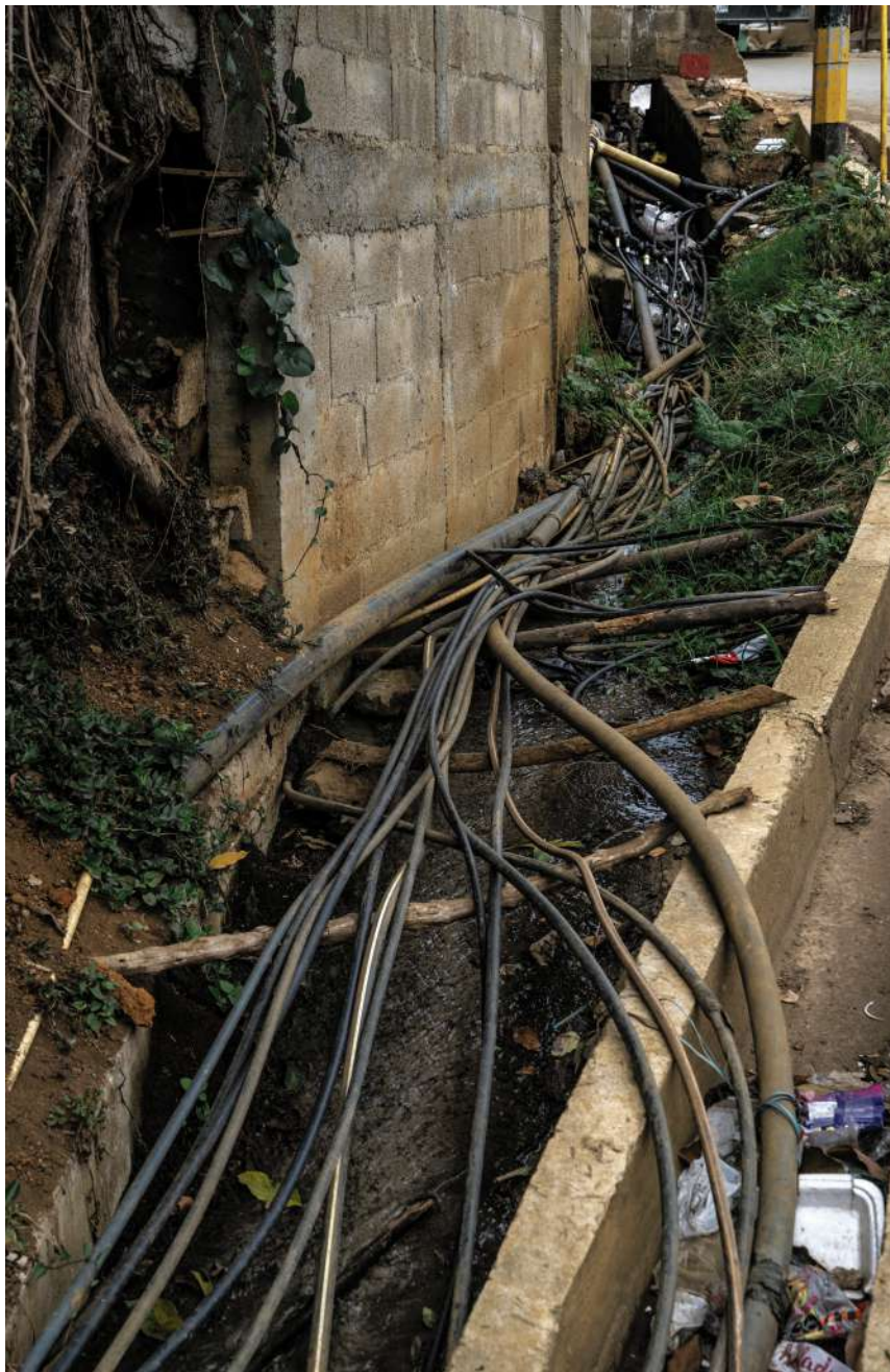
Acueductos hechizos construidos por la comunidad.
